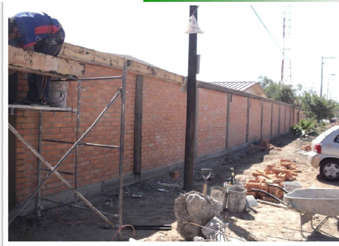
ESCUELA PRIMARIA "DOLORES REYES VELAZQUEZ" FRACCIONAMIENTO REAL DE PEÑASCO SAN LUIS POTOSI, S.L.P. REHABILITACION GENERAL DE LA INFRAESTRUCTURA
