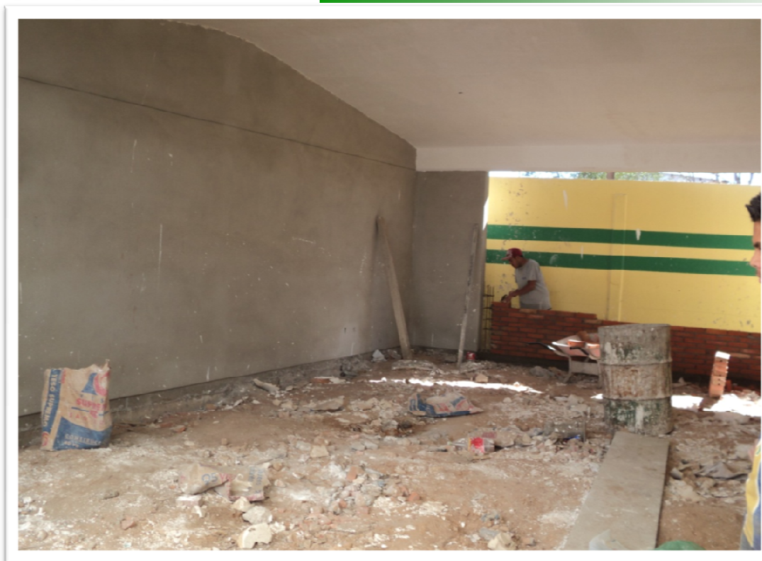
ESCUELA PRIMARIA "JUSTO SIERRA" COLONIA LAS PIEDRAS SAN LUIS POTOSI, S.L.P. CONSTRUCCION DE UN AULA DIDACTICA ESTRUCTURA REGIONAL 6.00 X 8.00 M. Y OBRAS EXTERIORES
