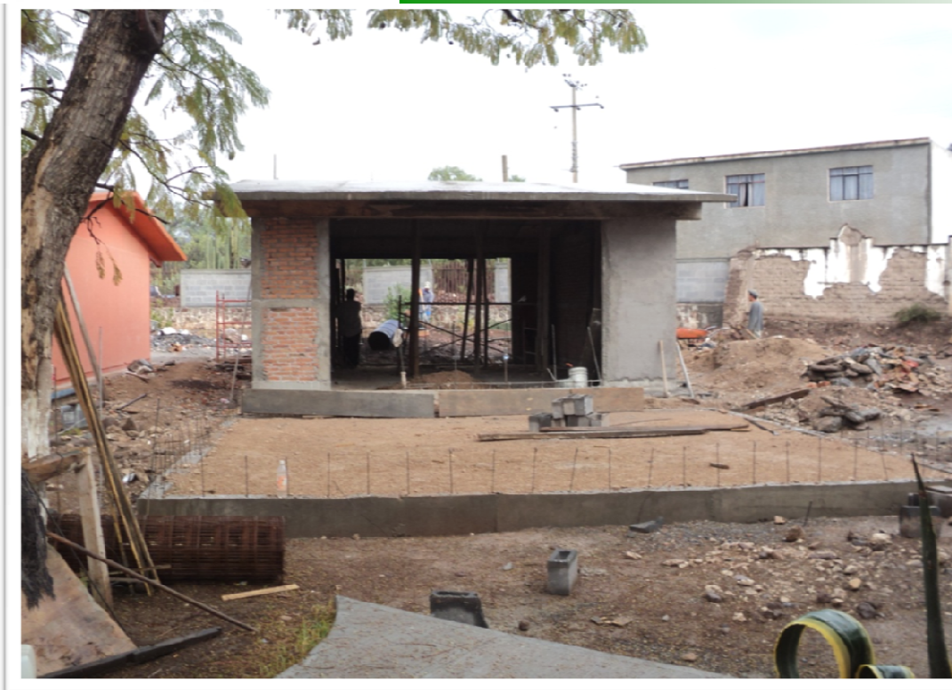
ESCUELA PRIMARIA "JOSE MA. MORELOS Y PAVON" YERBABUENA AHUALULCO, S.L.P. CONSTRUCCION DE UN AULA DIDACTICA ESTRUCTURA REGIONAL 6.00 X 8.00 M. Y OBRAS EXTERIORES
